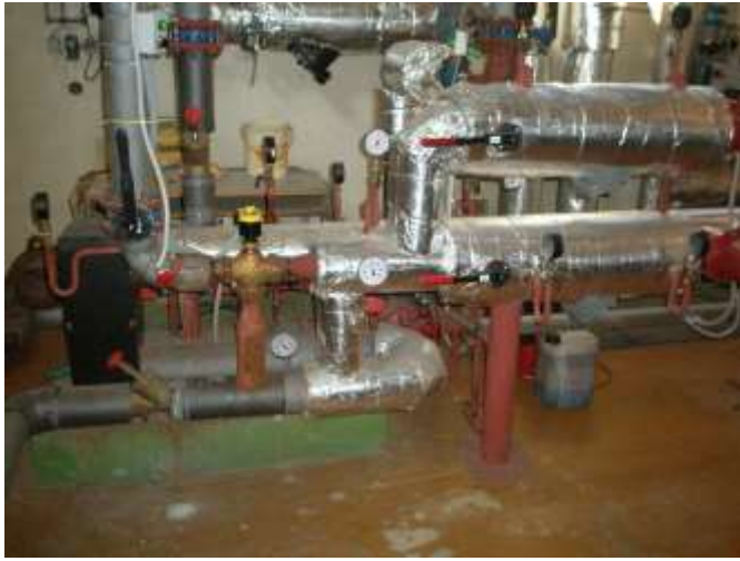
Obr. 2 - blok přípravy teplé vody (zásobníky TV 2x1600 litrů, deskový výměník, čerpadla, armatury)
