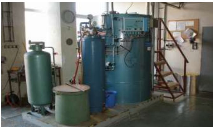
Obr. 4 - bloková úpravna vody
