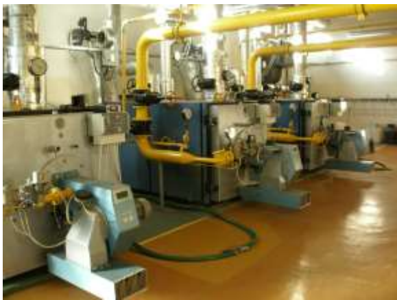
Obr. 1 - stávající plynové kotle KDVE 100 s hořáky PHD 18 PZ
